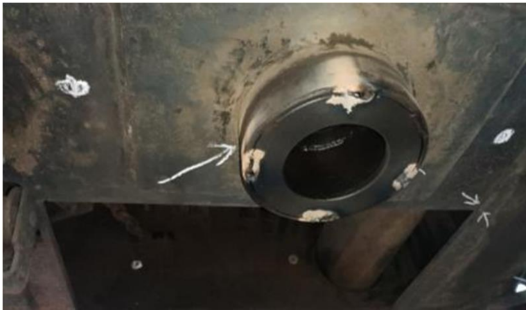
Рисунок 1.10 – Тріщини у шкворневому вузлі на головній рамі маневрового тепловоза ТЕМ2
