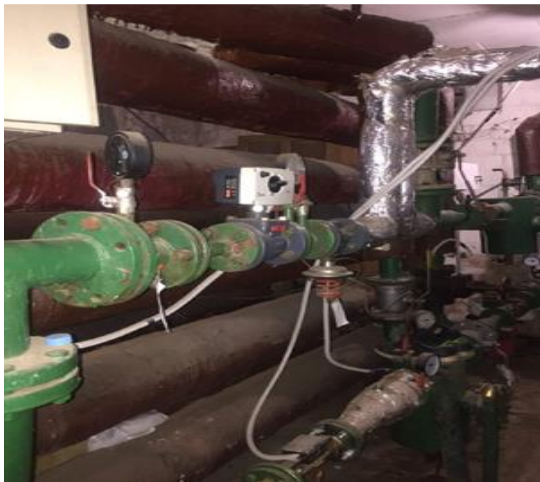
Рисунок 2.6 – Поточний стан трубопроводу.
