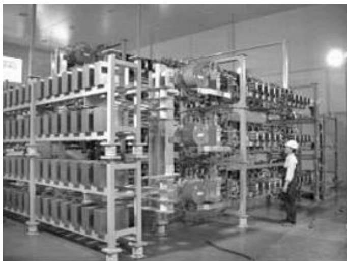
Рисунок 1.13 – Перетворювач напруги ОРПІ на ПС 154 кВ
