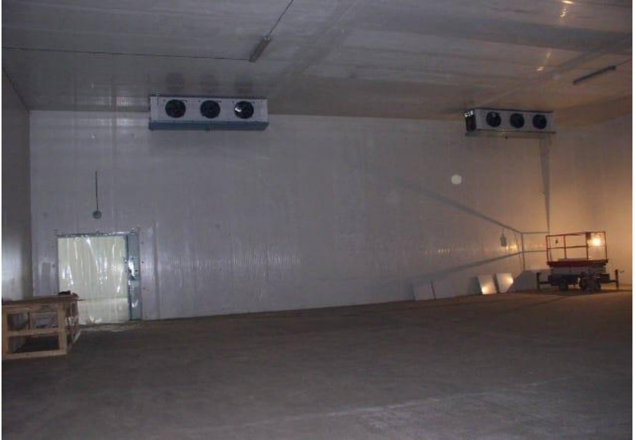
Рис. 3.4 Приміщення холодильної камери
