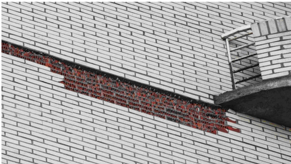
Рисунок 1.2 – Руйнування лицьового шару кладки на рівні плити перекриття
