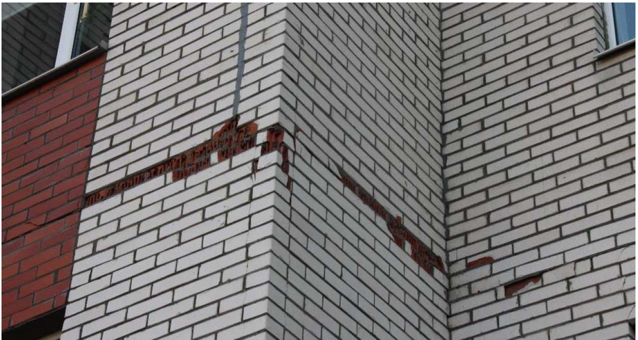
Рисунок 1.1 – Пошкодження кладки в зонах стику з плитами перекриття
