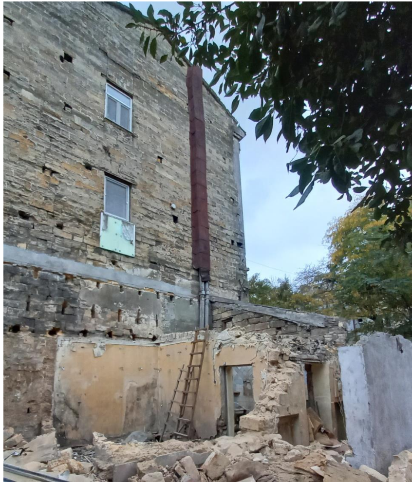
Рисунок 2.2 Зруйновані споруди на території, що досліджується
