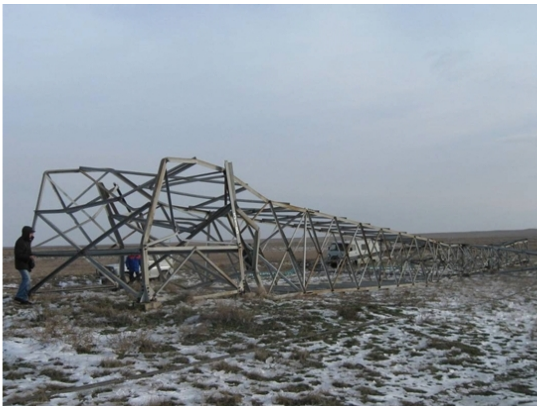
Рисунок 1.19 – Пошкодження проміжних опор ПЛ 330 кВ
