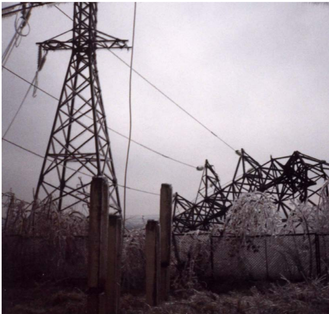
Рисунок 1.18 – Пошкодження металеві опори ПЛ 330 кВ
