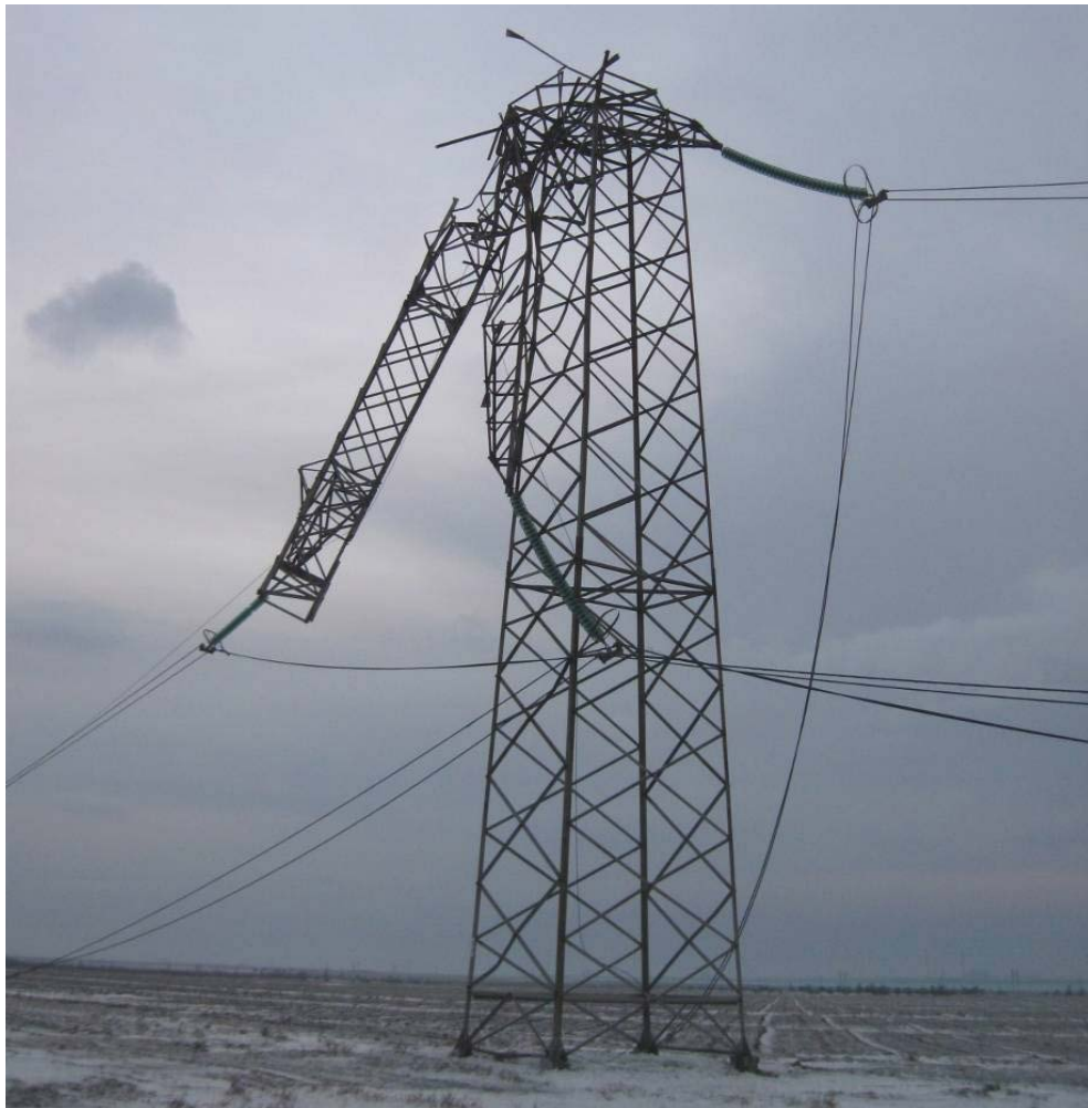
Рисунок 1.10 – Пошкодження опор та проводів ПЛ внаслідок галопування.
