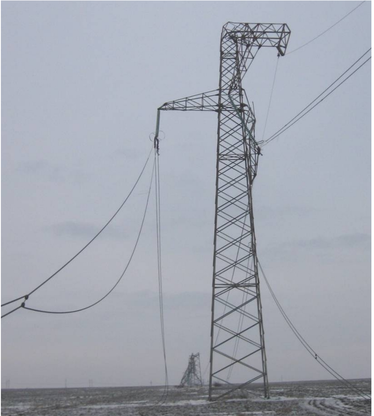
Рисунок 1.16 – Частково уціліла проміжна опора з обривом проводів ПЛ 330 кВ
