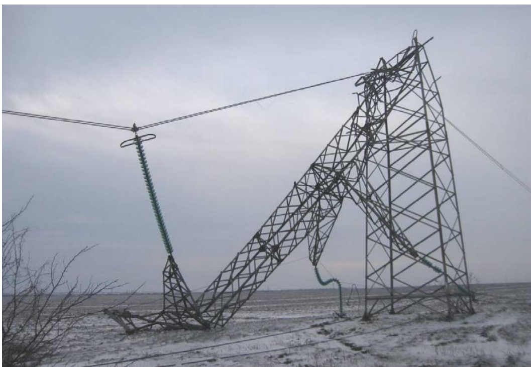
Рисунок 1.11 – Пошкодження опор та проводів ПЛ внаслідок галопування.
