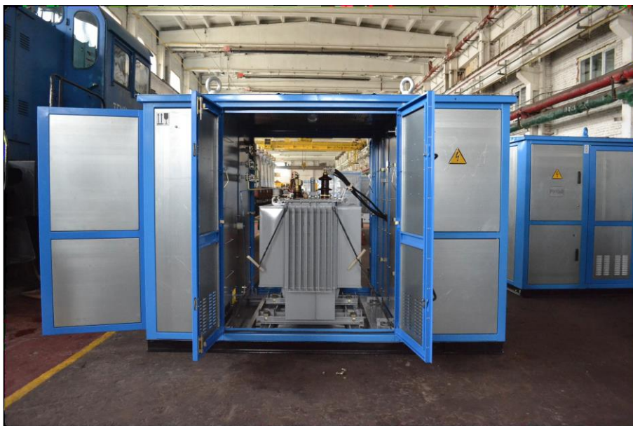
Рисунок 3.1 – Загальний вигляд КТП1
