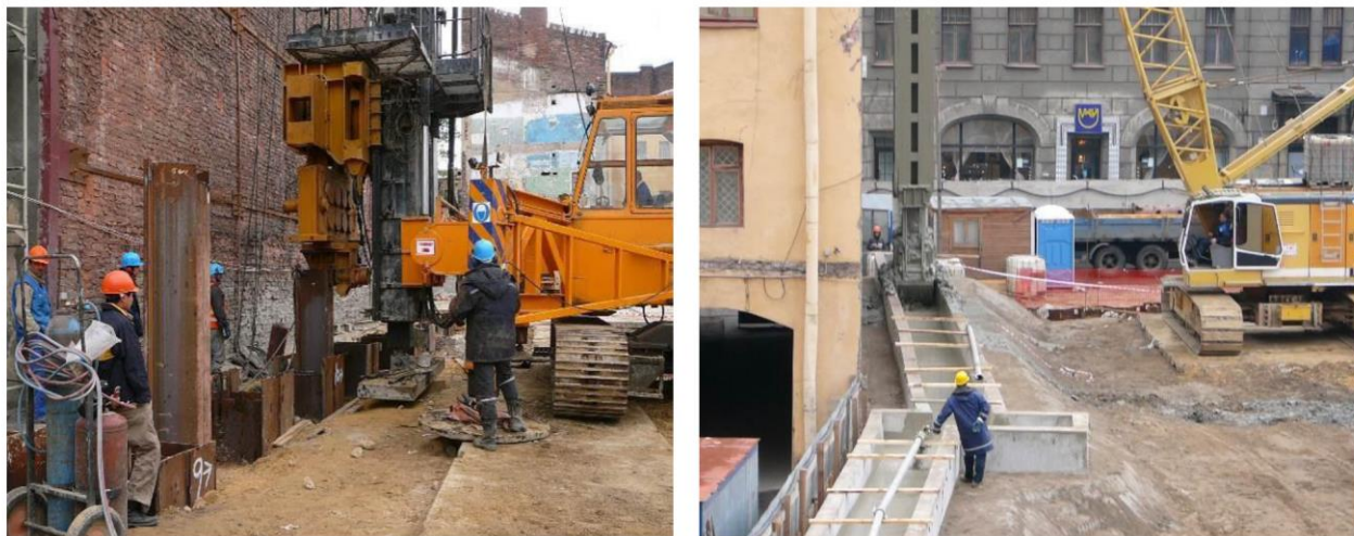
Рис. 1.2. Занурення шпунта і пристрій «стіни в ґрунті» біля існуючих будівель на об'єкті
