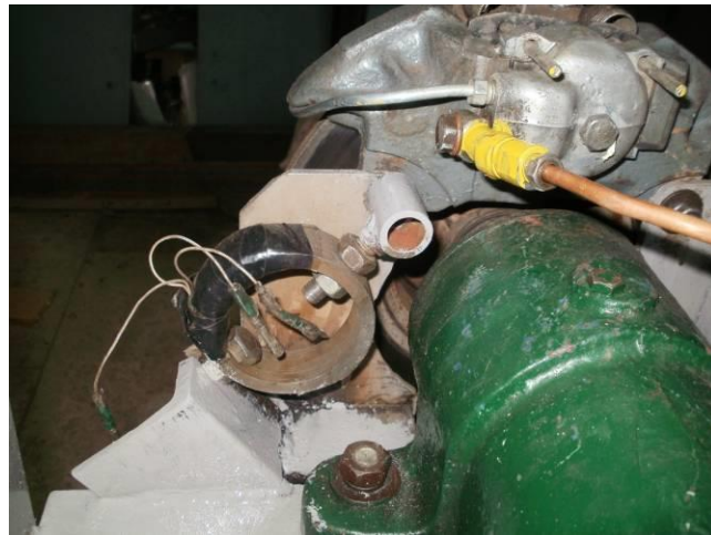
Рис. 7.10. Місце встановлення ДГМ
