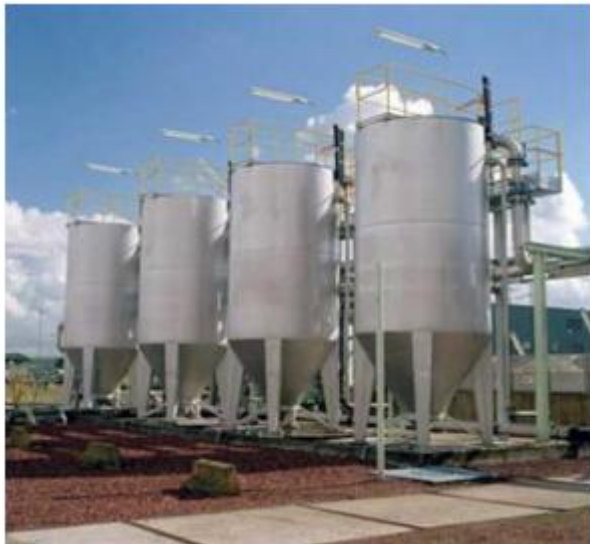
Рис 5.2 Автономна установка фільтрів у вигляді металевих конструкцій
