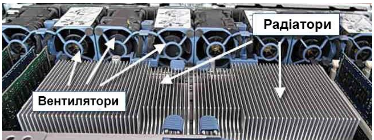
Рисунок 1.7 – Фото охолоджувальної системи сервера
